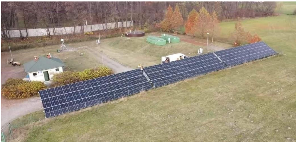
Zdj. 11. Instalacja fotowoltaiczna przy oczyszczalni ścieków w Czarnolesie
