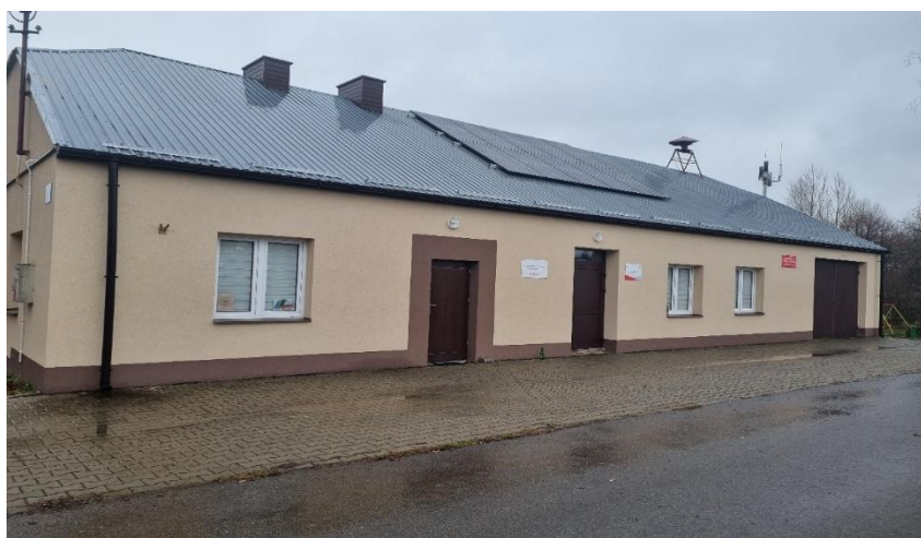
Zdj. 12. Instalacja fotowoltaiczna na budynku OSP Zawada Stara
